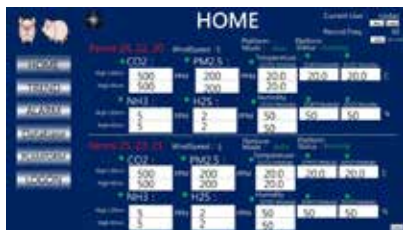
中央监控软件主画面
